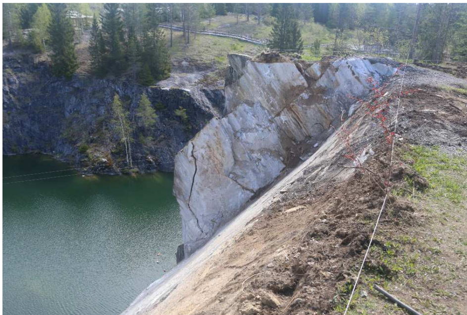
Fig. 9. The result of the collapse of the hanging parts of the site (shown in Fig. 7) (photo by V. Shekov) Рис. 9. Результат обрушения свисающей части площадки (рис. 7) (фото В. Шекова)
