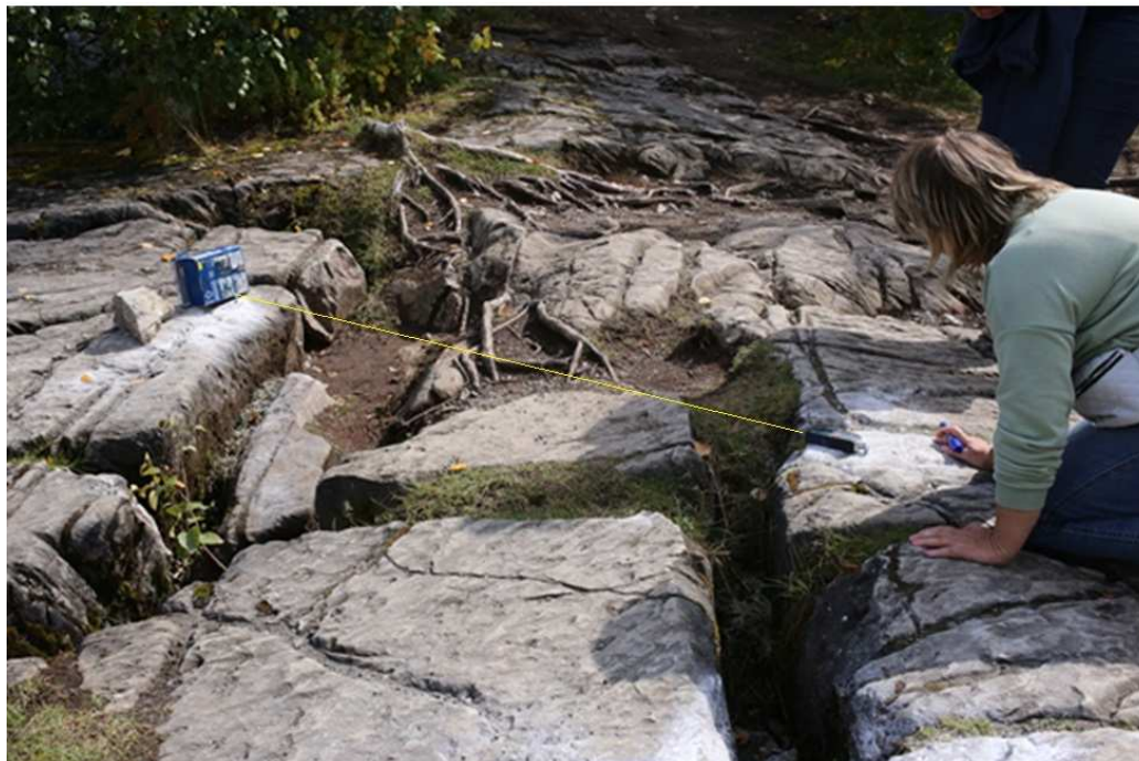
Fig. 16. Measuring the distance between two metal screws set to control crack expansion parameters Рис. 16. Измерение расстояния между двумя металлическими винтами (реперами), установленными для контроля параметров расширения трещин
